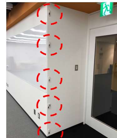
SALCの 温湿度・CO2検出 センサー設置例
